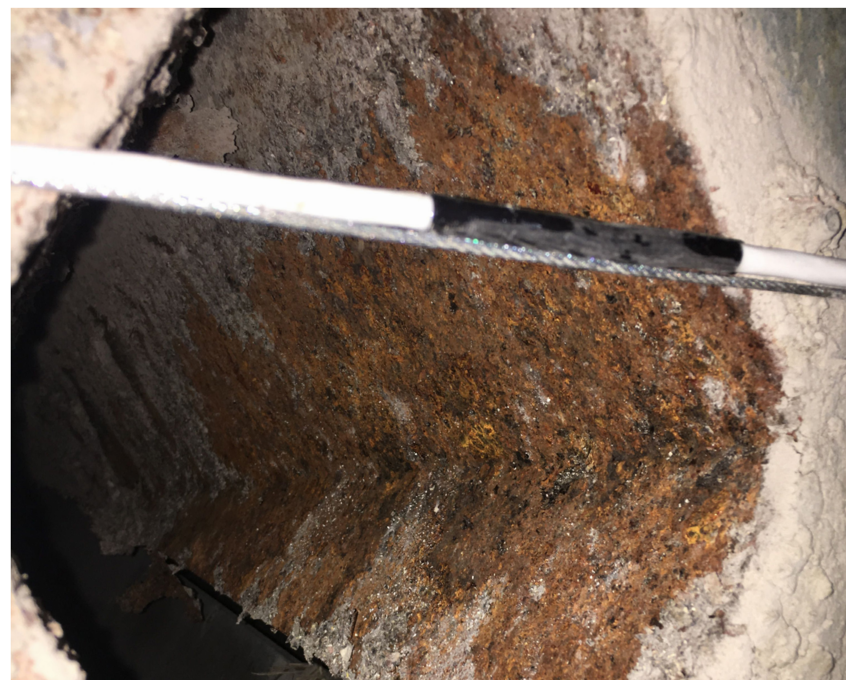
2. kép Hidegoldali légcsatorna (Forrás: preciziosszaritas.hu)
