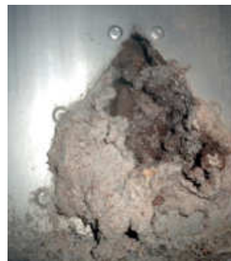
→ Eltömődött kilépőnyílás. A nedvességgel telített szárítóközegnek itt kellene kilépnie a légcsatornából
